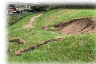
<水城跡の法面崩壊>
